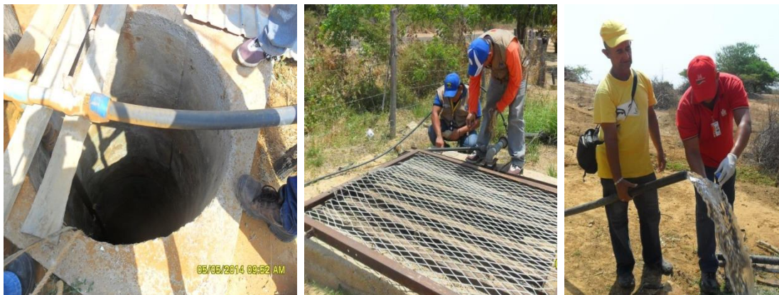
Figura 2. Imágenes de algunas de las fuentes de abasto. Izq. Pozo artesanal; Centro: Cisterna; Der. Tubería de aducción.
