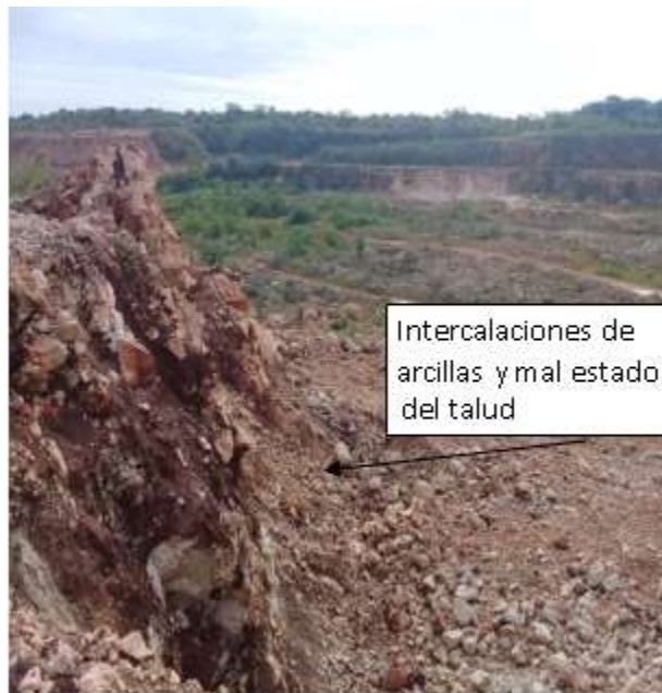
Figura 2. Presencia de bolsones de arcilla y mal estado de los taludes.
