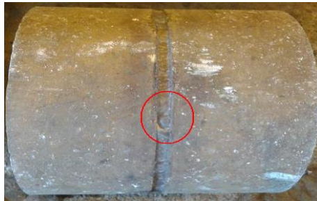
Figura 5. Análisis macrográfico del cordón de soldadura.
