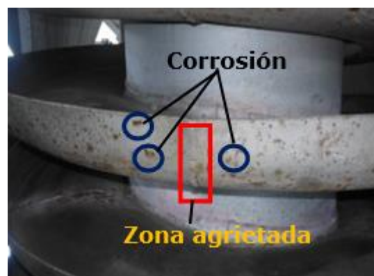
Figura 1. Zona donde se muestra el fenómeno de agrietamiento.
