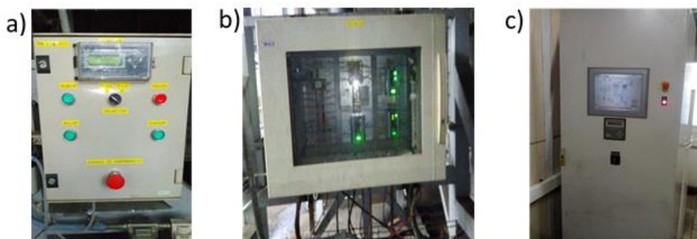
Figura 6. Armarios de control de la unidad de dosificación y pesaje.
