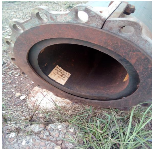
Figura 2. Tubería de la impulsión de la bomba de material Pexgol.
