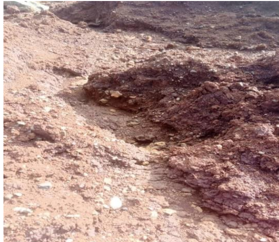
Figura 4. Efectos de la erosión y el agrietamiento.
