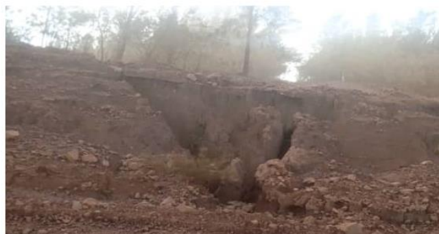
Figura 5. Inestabilidad del terreno.
