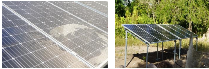
Figura 3. Humedad y efecto de sombras en los paneles solares instalados.
