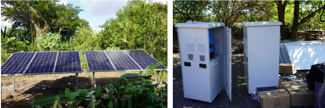
Figura 2. Módulos fotovoltaicos instalados en la comunidad y gabinetes tecnológicos usados en la implementación de los sistemas.
