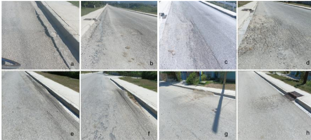
Figura 3. a) Hundimiento. b) Vertido de concreto en la vía, desprendimiento de agregados y huecos. c) Desprendimiento de agregados. d) Piel de cocodrilo. e) Abultamiento, hundimiento y ahuellamiento. f) Abultamiento, hundimiento ahuellamiento y exudación. g) Abultamiento y hundimiento. h) Agrietamiento en bloque.
