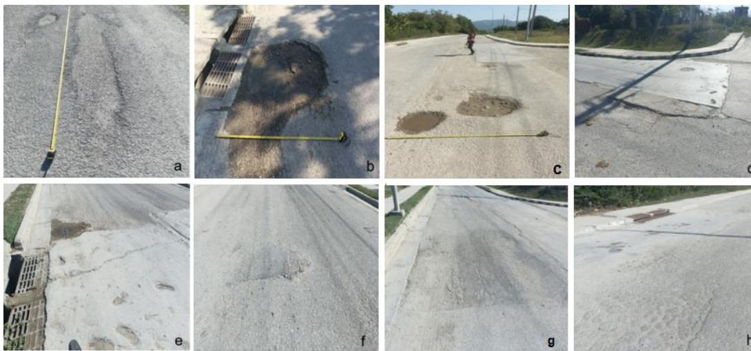
Figura 2. a) y b) c) Huecos. d) Parcheo, hundimiento. e) Parcheo, hueco y grieta transversal en losa de hormigón. f) Vertido de concreto en la vía, desprendimiento de agregados. g) Grietas longitudinales, parche de concreto y hundimiento. h) Piel de cocodrilo y parche.
