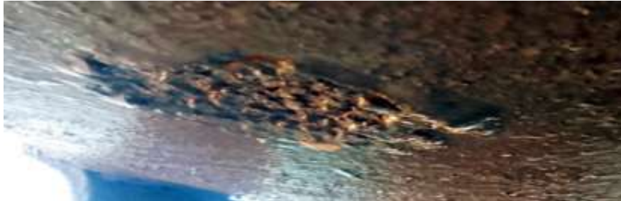
Figura 5. Área afectada por corrosión por pitting . (Parte inferior del recipiente).
