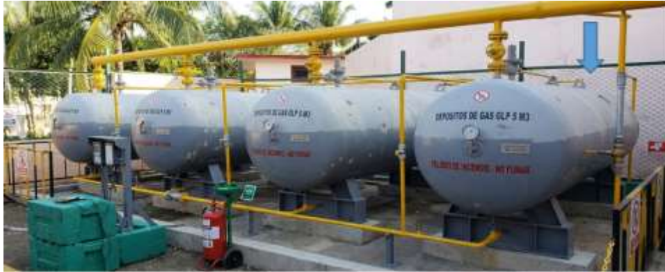
Figura 1. Vista general de la batería de recipientes de GLP del Hotel Brisas Guardalavaca, indicando la posición del recipiente 4.
