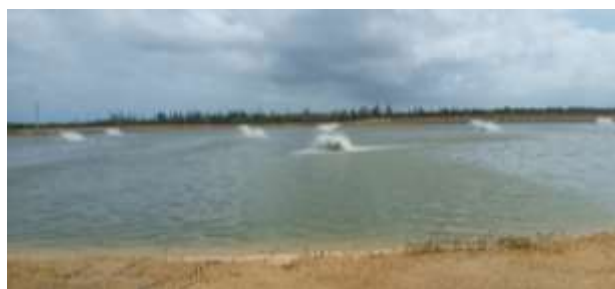
Figura 4. Vista de los aireadores en el estanque 45.
