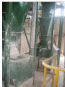
Figura 1. Dosificadores de cal.
