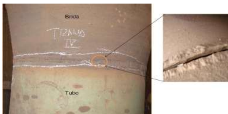
Figura 2. Unión por soldadura del tramo IV del transportador Jacoby. El detalle muestra la falla en la soldadura.
