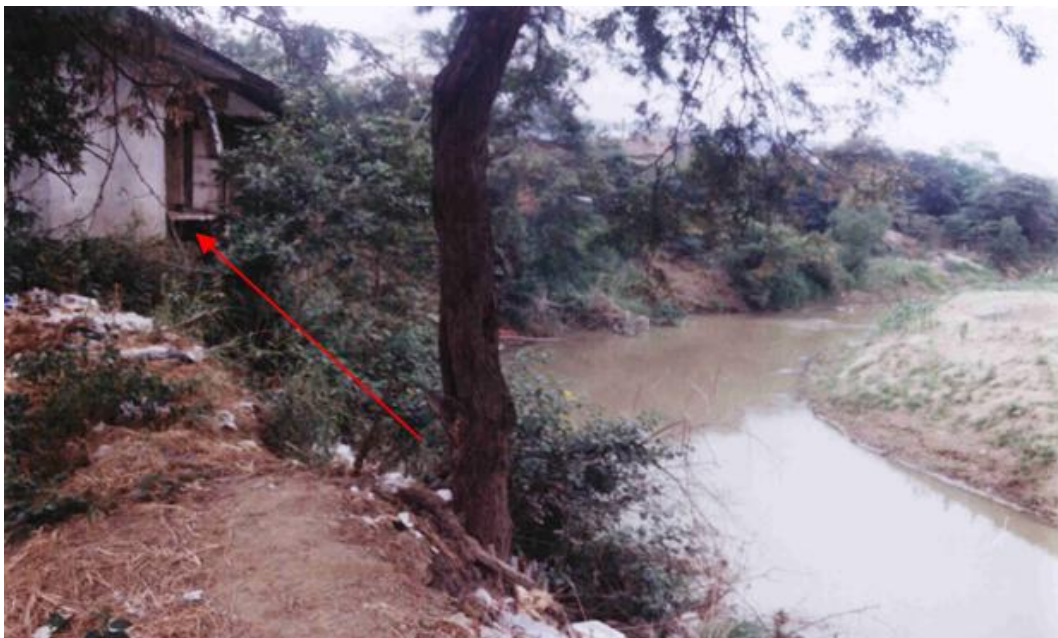
Figura 1. Vivienda afectada por la erosión del río.
