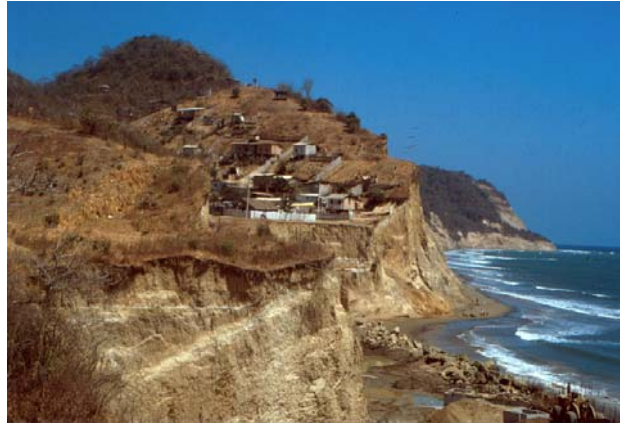
Figura 3. Estado físico-geológico de los taludes en el litoral costero de de Manabí, donde se observa el grado de deterioro de las rocas.
