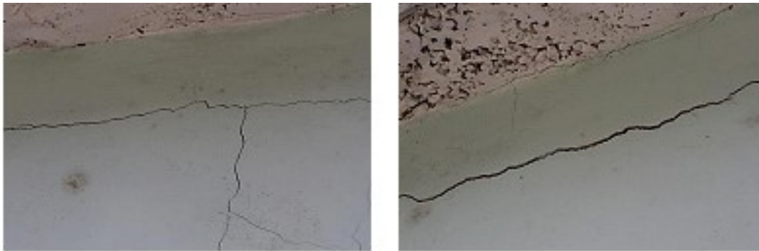
Figura 5. Grietas pasantes en muros de mampostería. Vivienda en Santa Marta. Fuente: Chuy et al. (2017).
