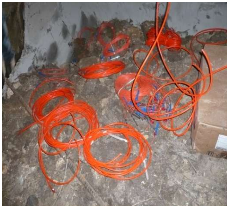
Figura 4. Cordón detonante de alto gramaje utilizado en la voladura de contorno por recorte en el túnel de Buenaventura (Trasvase Este-Oeste).
