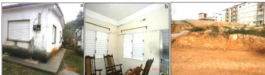
Figura 8. Fenómenos geotécnicos en el tipo ingeniero-geológico aluvial marino fino. Donde, a y b: grietas bien desarrolladas en los muros de la vivienda y c: afloramientos de arcillas en las cercanías de la vivienda.
