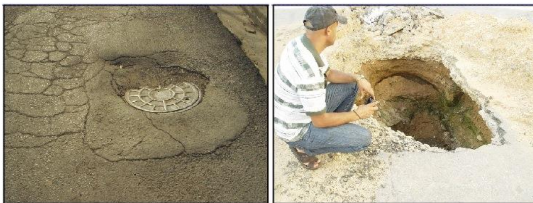
Figura 7. Hundimientos y colapsos de carreteras debido al fenómeno de erosión subterránea, ciudad de Pinar del Río, Cuba Occidental.
