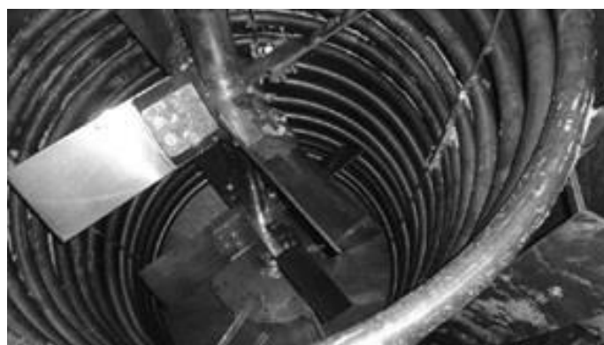
Figura 1. Serpentín donde ocurrió falla de codo.
