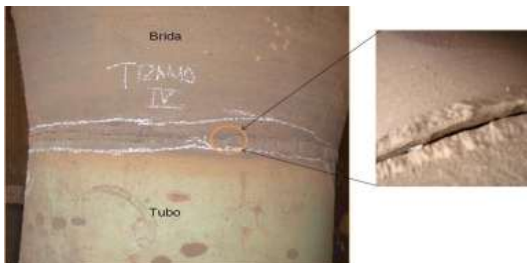
Figura 2. Unión por soldadura del tramo IV del transportador Jacoby. El detalle muestra la falla en la soldadura.
