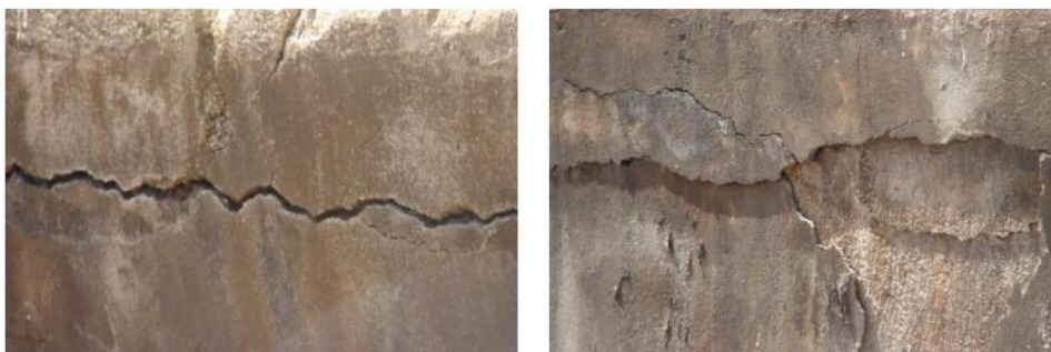
Figura 6. Grietas en la estructura (Acosta-González 2011).
